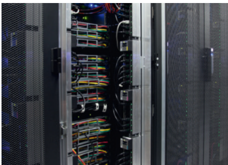
Mit Liebert DCL-Einheit gekühltes Vertiv™ Knürr® DCM Heavy-Duty Rack mit Liebert-Stromverteilungsmodulen und integriertem Kabelmanagement
