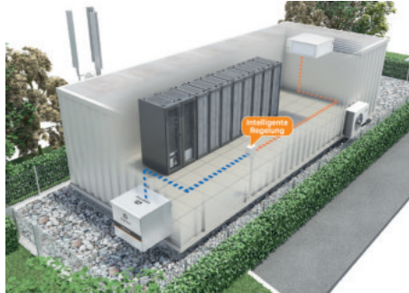
Mit Liebert HPS
