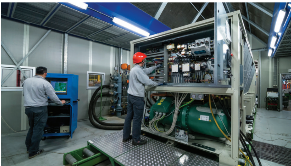
Die speziellen Testkabinen wurden entwickelt, um die Zuverlässigkeit beim Testen der Einheiten zu optimieren. Durch die Simulation tatsächlicher Installationsbedingungen wird die Leistungsstärke der Einheit gewährleistet.
